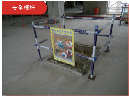
電梯開口防護
