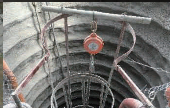
垂直梯設置垂直防墜器
