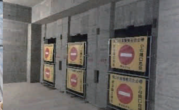
電梯開口防護
