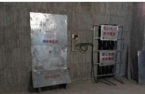
廢棄物料管道開口防護
