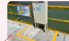
臨時電盤放置區採畫線管理
