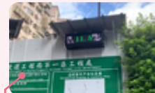
工區出入口設置PM2.5偵測儀器
